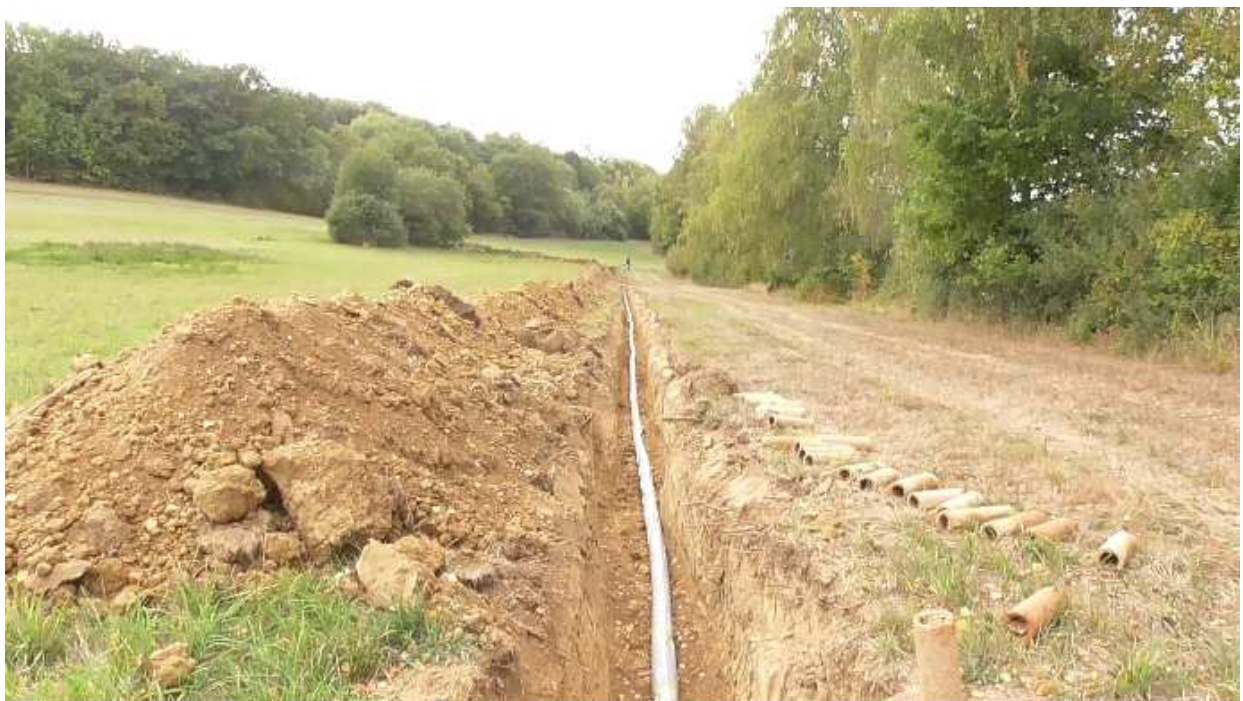
Abb. 0-3: Die alten Ton-Rohre „zogen“ schon lange kein Wasser mehr aus der Wiese...sie zogen eigentlich nie wirklich – ein lebenserhaltendes Restwasser blieb seit Jahrzehnten zur Aufrechterhaltung einer kleinen Biodiversität im Wiesenareal
